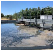
TRATAMIENTO DE AGUA
