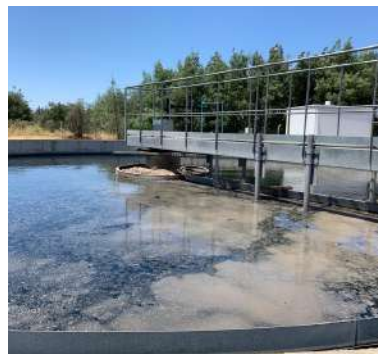
TRATAMIENTO DE AGUA
